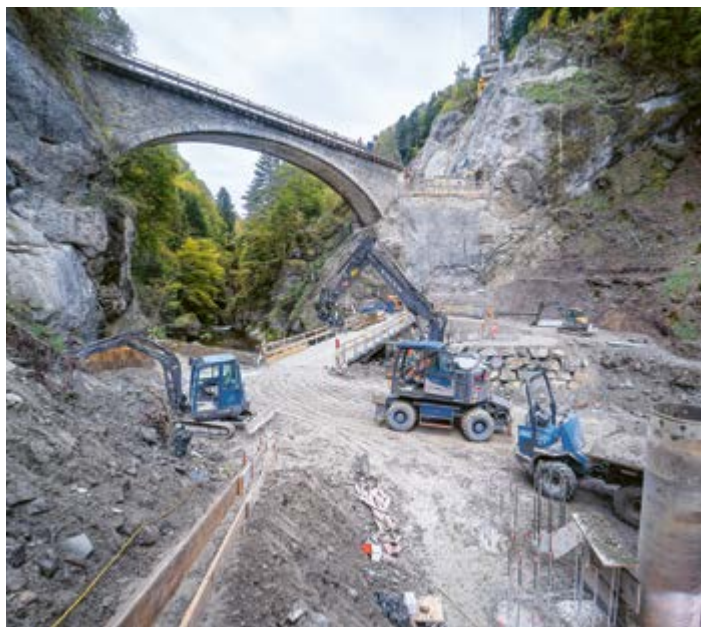
Um am gegenüberliegenden Ufer das Widerlager für die neue Brücke zu erstellen, wurde eine provisorische Brücke errichtet.
